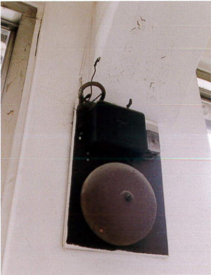
廊下に設置のベル
