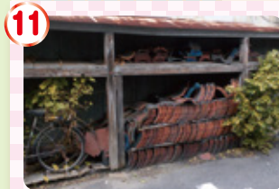
11 地震が来たときにあぶないと ころがあった。あぶないと言 いて看板をかける。 この道を通るときは気をつけ て歩いて下さい。
