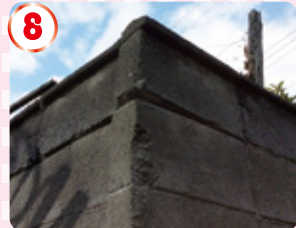
8 ブロック塀が崩れそうであ ぶない。近くを通らない。
