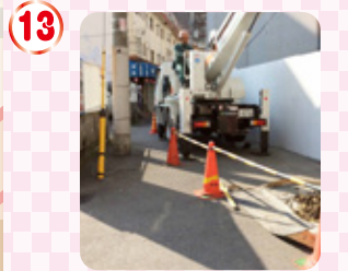
通行止め (工事中) 危険なので近づかない。
