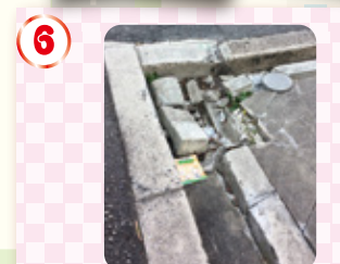
6 ブロックが崩れている。 落ちたらあぶない。
