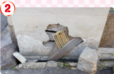
2 崩れそうな建物があった。 地震などが来た時は、通らないほうが良い。
